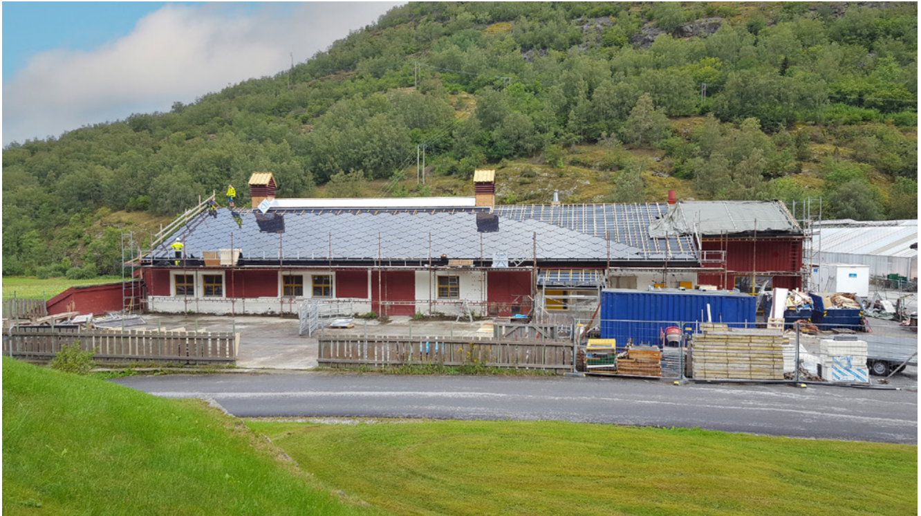
Solcellepanel på Sogn jord- og hagebruksskule. Foto: Vestland fylkeskommune
